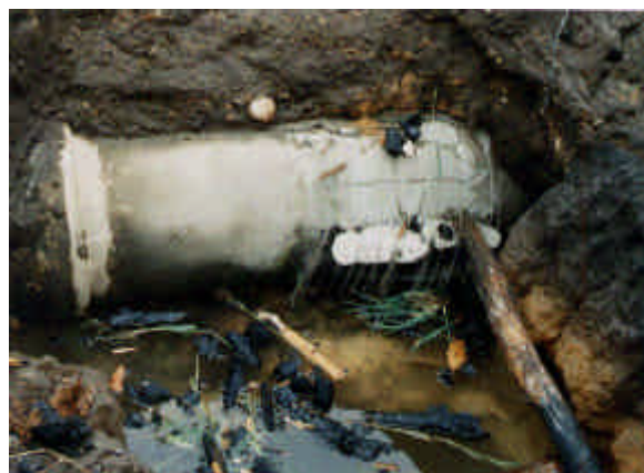
PC管破裂状況 (群馬用水 箕郷群馬支線 1,100mm H5.9)
