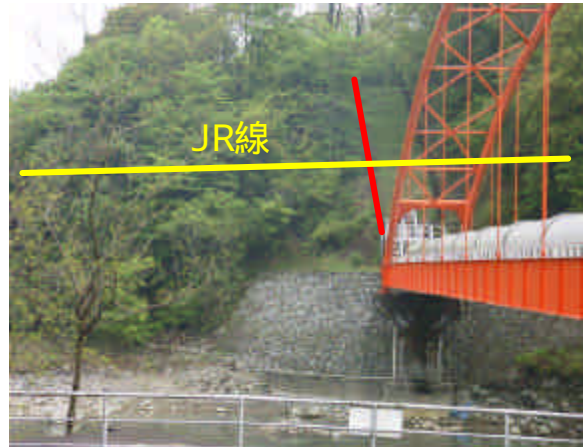
サイホン下流側を望む 用水管は急斜面を上りJR吾妻線上部を通過
