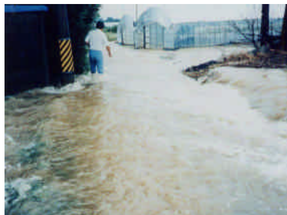
PC管破裂による出水状況 (豊川用水 伊良湖サイホン 1,100mm H5.9)
