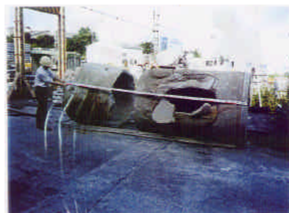
PC管破裂 (大和平野 桜井サイホン 1,200mm H11.8)
