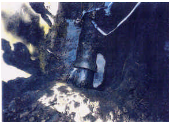
PC管漏水状況 (継目からの漏水) (群馬用水 相馬支線)
