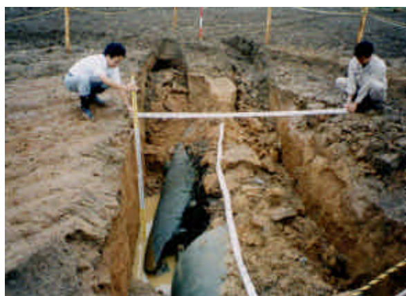
PC管破裂状況 (豊川用水 伊良湖サイホン 1,100mm H5.9)
