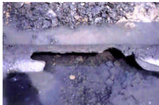
石綿セメント管の破損状況
