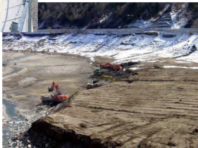
牧尾ダム湖内堆砂除去工事状況 (大岩橋下流部) 平成15年3月撮影
