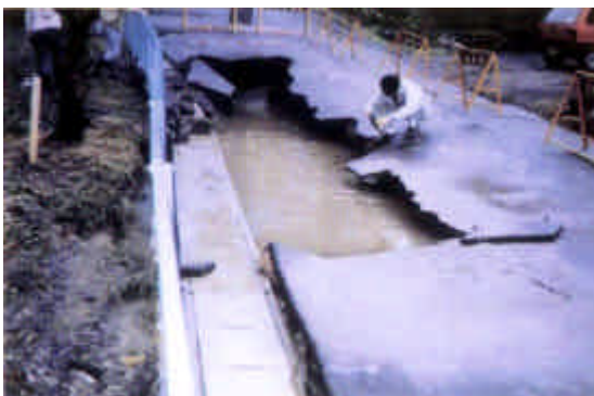
漏水事故による周辺の被害状況
