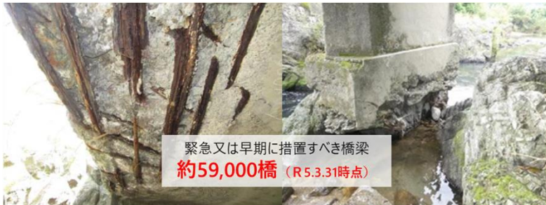
橋梁の裏側の鉄筋露出 <判定区分Ⅲ>
