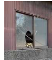
窓が割れた 管理不全空家
