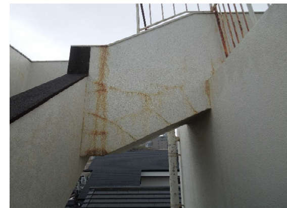
外部階段: ひび割れが多数発生し、錆汁が見られる
