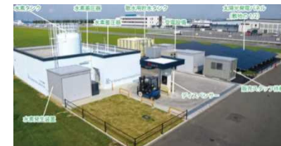
貨物地区水素充填所
