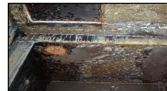
汚水処理装置(タンク及び周辺機器)の腐食、等
