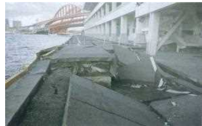
岸壁の被災(神戸港)
