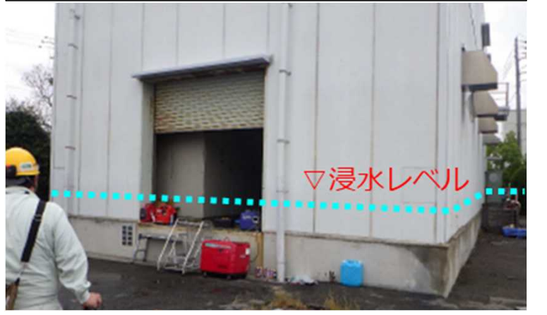
電源施設の浸水
