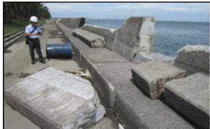
高波による護岸倒壊(神奈川県横浜市)
