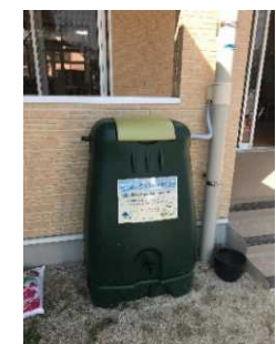
雨水貯留タンクの設置状況(福岡県)
