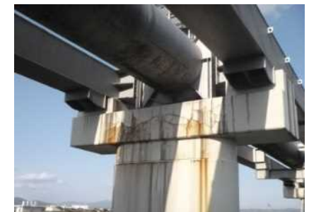
水管橋 橋脚のひび割れ
