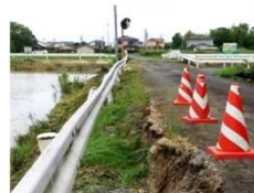
クリーク法面崩壊
