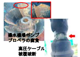
高圧ケーブル被覆破断 電気・機械設備の経年劣化
