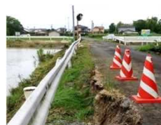
クリーク法面崩壊
