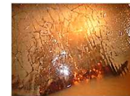
管内面のひび割れ
