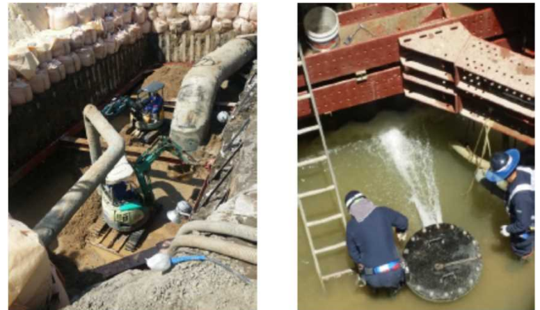
出典：厚生労働省 平成28年(2016年)熊本地震 水道施設被害等現地調査団報告書
