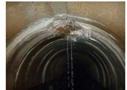
トンネル天頂部の欠損
