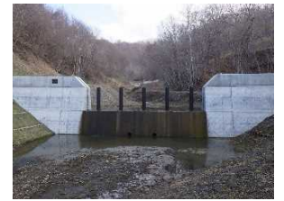
流木捕捉機能を持った治山ダム ※令和3年度は37地区で設置
