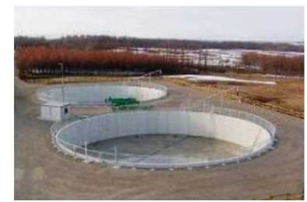
スラリーを貯留する配水調整池
