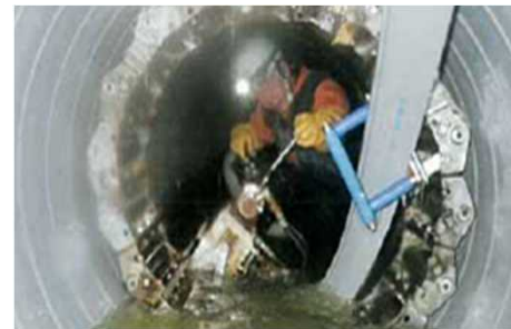
下水道施設の耐震化事例
