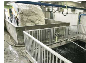
融雪槽への投雪状況
