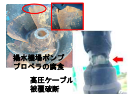
高圧ケーブル被覆破断 電気・機械設備の経年劣化
