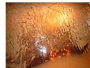
管内面のひび割れ
