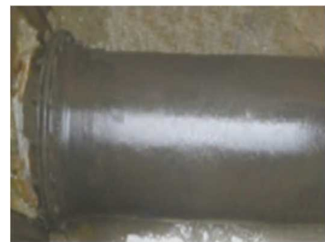
装着管の状況(腐食性土壌36年経過)
