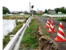
クリーク法面崩壊
