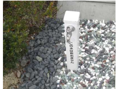
利用施設(庭散水用)
