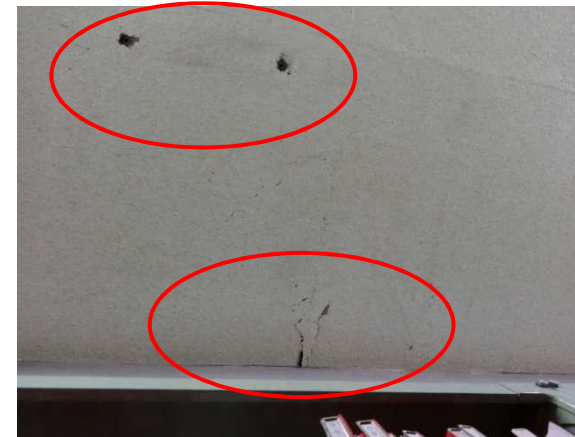
1号館3階耐火書庫: 天井にコンクリートの爆裂等が見られる
