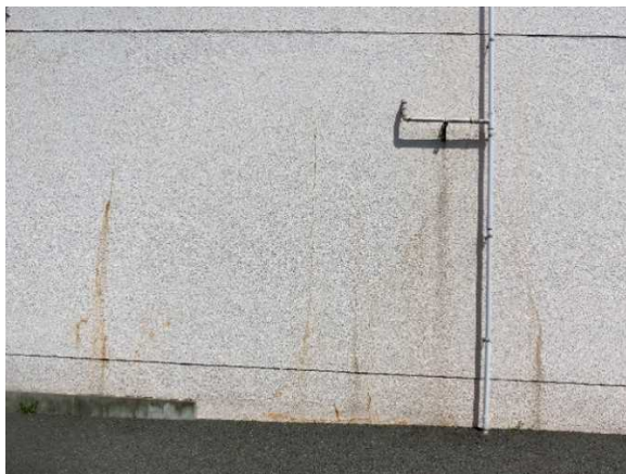
西面外壁: ひび割れ、爆裂が多数発生している
