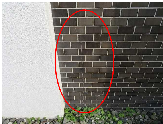
西面外壁: タイルのひび割れが発生している
