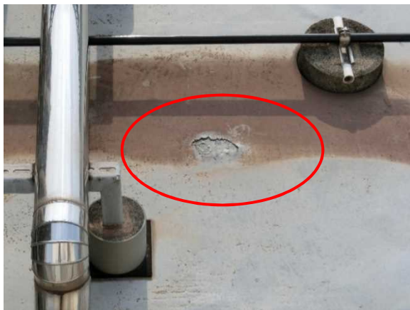
屋根: 屋上防水のふくれ、亀裂が見られる
