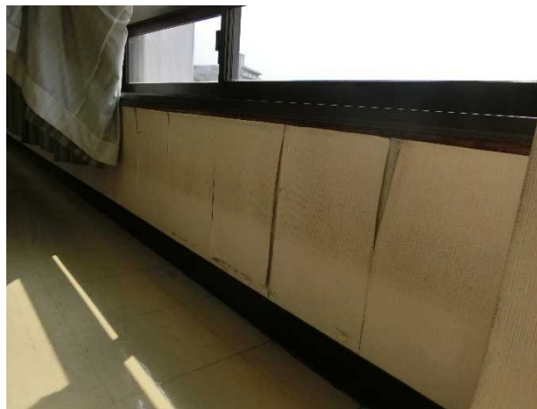
4階共用会議室:漏水による室内壁の仕上材の剥がれが見られる
