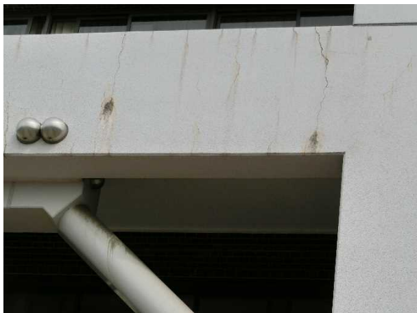
南面外壁:ひび割れ、爆裂が多数発生している
