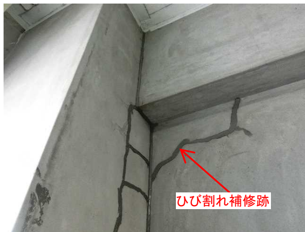
5階書庫:室内の壁にひび割れが多数発生している
