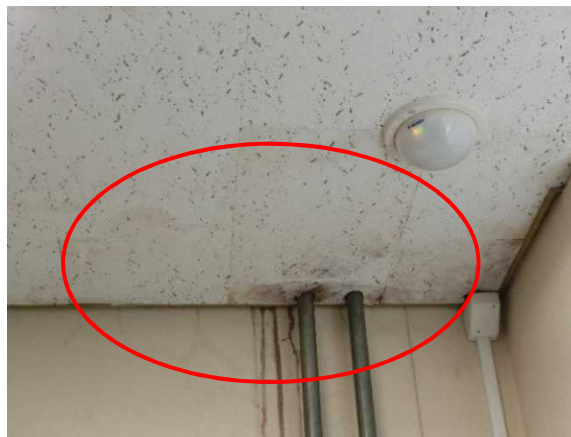
2号館2階事務室: 天井・室内壁に漏水が見られる
