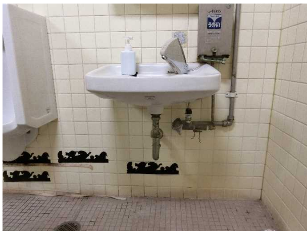
男性便所:配管からの漏水が頻発している 臭気が強く、清掃では解消されない
