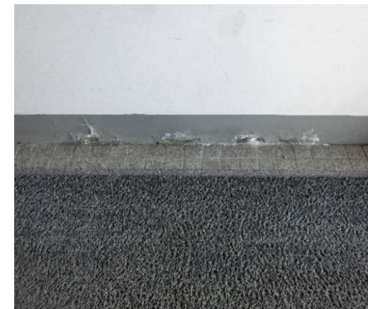
1階廊下: 室内壁の仕上材の剥離が見られる
