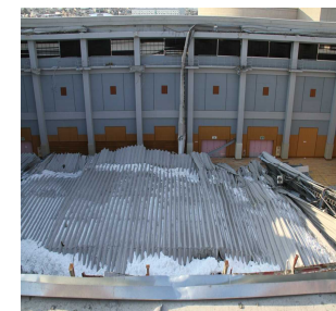
体育館の屋根崩落被害(埼玉県)
