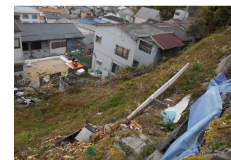
高台にある所有者不明土地から、瓦礫や岩石、柵等が落下するおそれ
