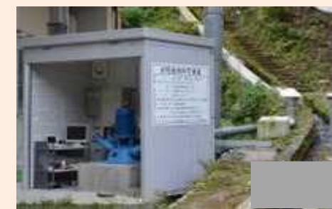
小水力発電設備
