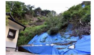
豪雨の度に土砂崩れが多発
