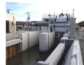
下水道施設(雨水ポンプ場)
