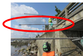
▲ PC鋼材の突出事例
