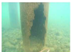
▲ パイロントの断面欠損
