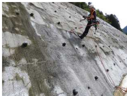
吹付が割れて水が入っている
