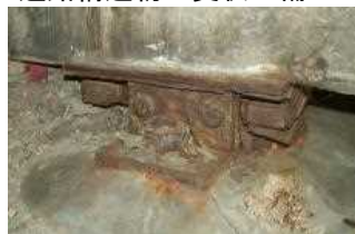
支承部の腐食
