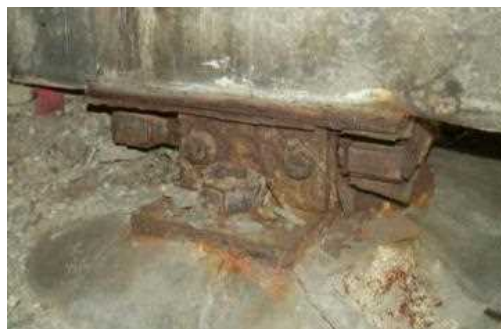
支承部の腐食
