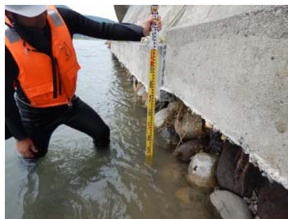
写真 擁壁基礎部・底盤部の洗掘の例
