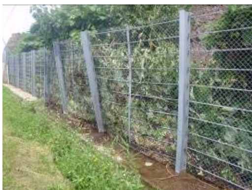
写真 落石防護柵の傾動の例
