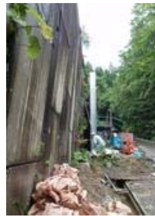
写真 壁面の傾斜の例
