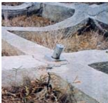
写真 受圧構造物の破損の例
