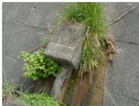
写真 アンカーの頭部からの湧水・雑草の繁茂の例
