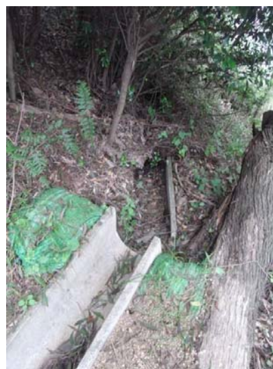
写真 排水溝の破損の例
