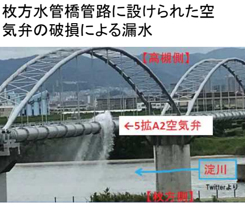
枚方水管橋管路に設けられた空気弁の破損による漏水 【高側側】 ←5拵A2空気弁 淀川 【低側側】 (空気弁: 管路内の空気を自動的に排気又は管路内へ吸気する装置)
