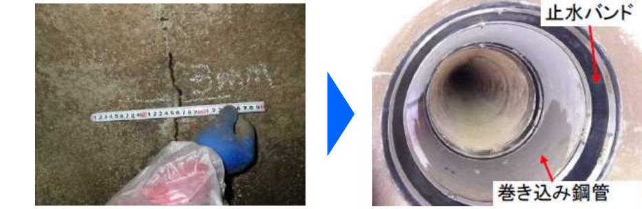
止水バンド 巻き込み鋼管 出典: 国営湖東平野土地改良事業概要(近畿農政局)
