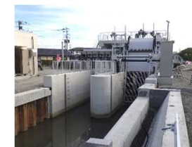
下水道施設(雨水ポンプ場)
