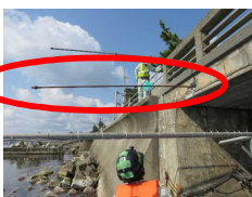
▲ PC鋼材の突出事例
