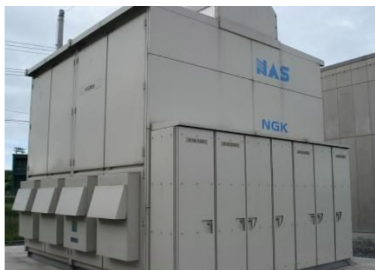
大型蓄電システム施設
