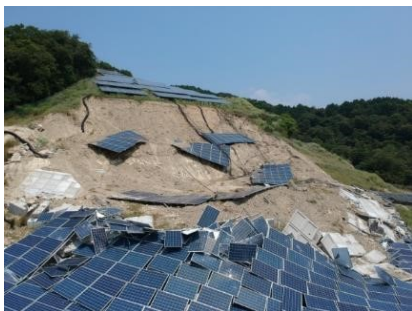
土砂崩れで生じた崩落
