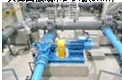
久御山広域ポンプ場(31kW)
