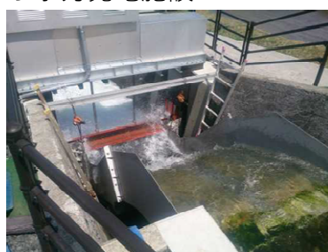
小水力発電施設
