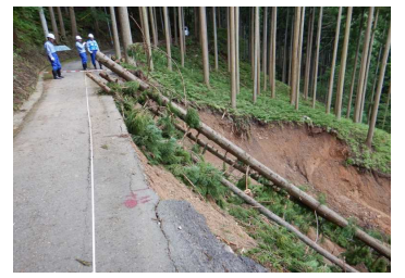
法面崩壊状況調査(京都府)
