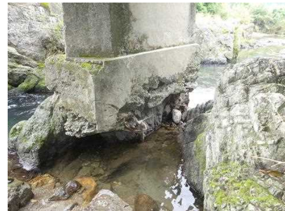
地方自治体管理 橋脚洗掘
