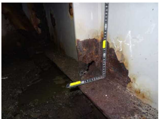
国管理 主桁腐食・欠損
