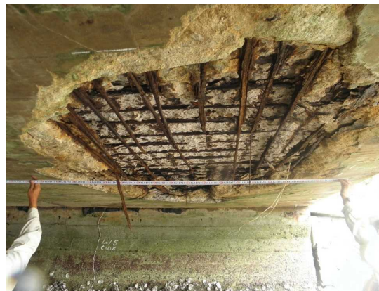
地方自治体管理 床版鉄筋露出
