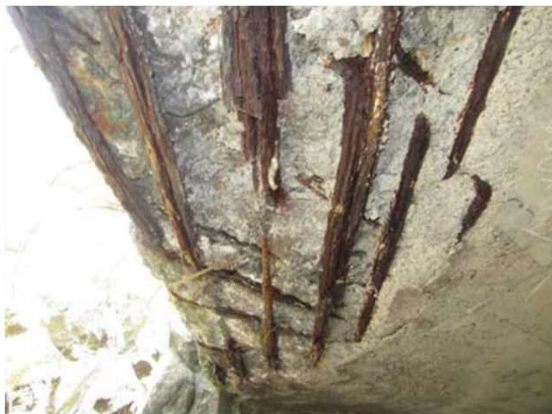
国管理 床版鉄筋露出 ※床版：橋の裏側
