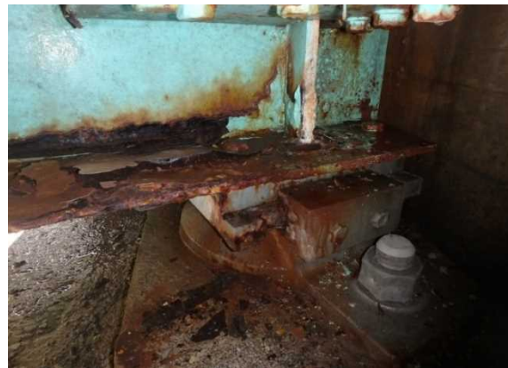
地方自治体管理 主桁腐食
