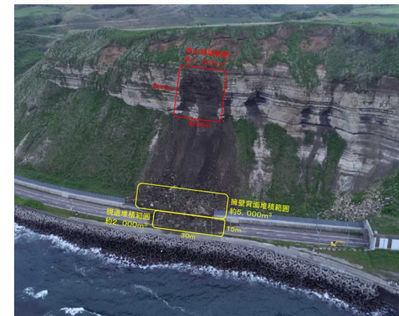
■国道229号 北海道爾志郡乙部町館浦 令和3年6月6日発生
