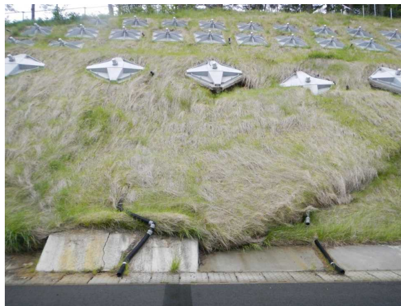
■三陸沿岸道路(久慈北道路):切土部 令和3年5月27日発生
