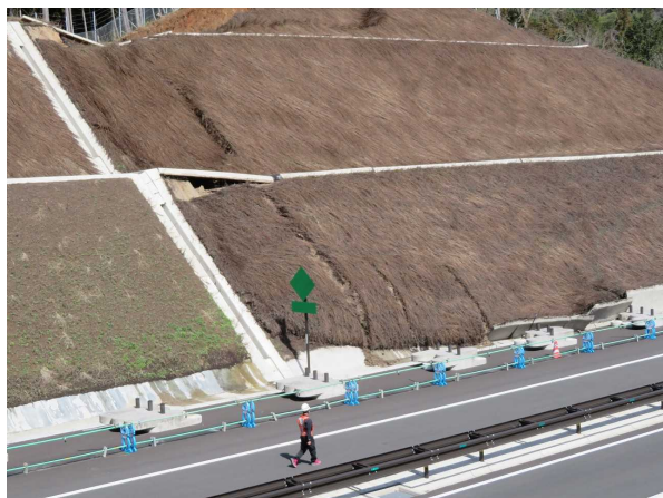
■国道483号日高豊岡南道路:切土部 令和3年3月18日発生
