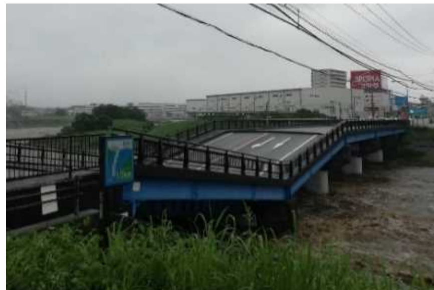
■(一)富士清水線 黄瀬川大橋:P4橋脚沈下・傾斜 令和3年7月3日発生
