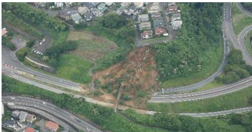
■E16横須賀横浜道路 逗子IC:切土法面崩落 令和3年7月3日発生
