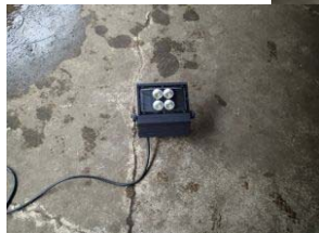
照明の設置状況
