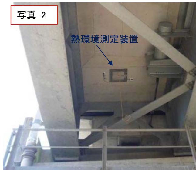
熱環境測定装置設置状況
