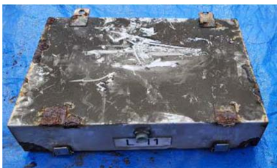
照明灯具の背面（取付脚の腐食）
