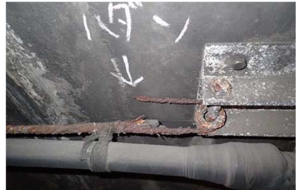
破断した取付部材
