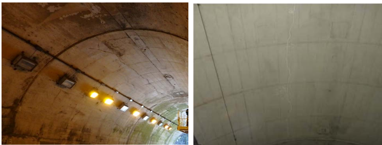
付写真-1.2 覆工の天端付近に発生した縦断方向のひび割れの例
