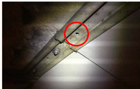
付写真-1.4.5 導水樋の止め金具が脱落した例
