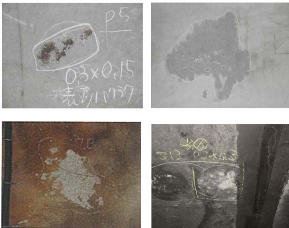
付写真-1.4.2 覆工コンクリートが変色している例 (うき・はく離を伴う例)
