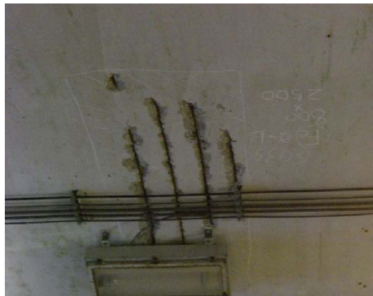
付写真-2.2 鋼材腐食の例
