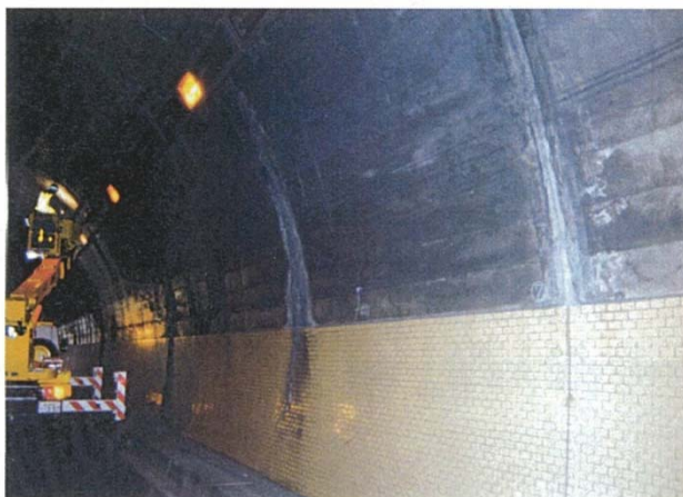
付写真-1.3 覆工スパンの中間付近に発生したひび割れの例
