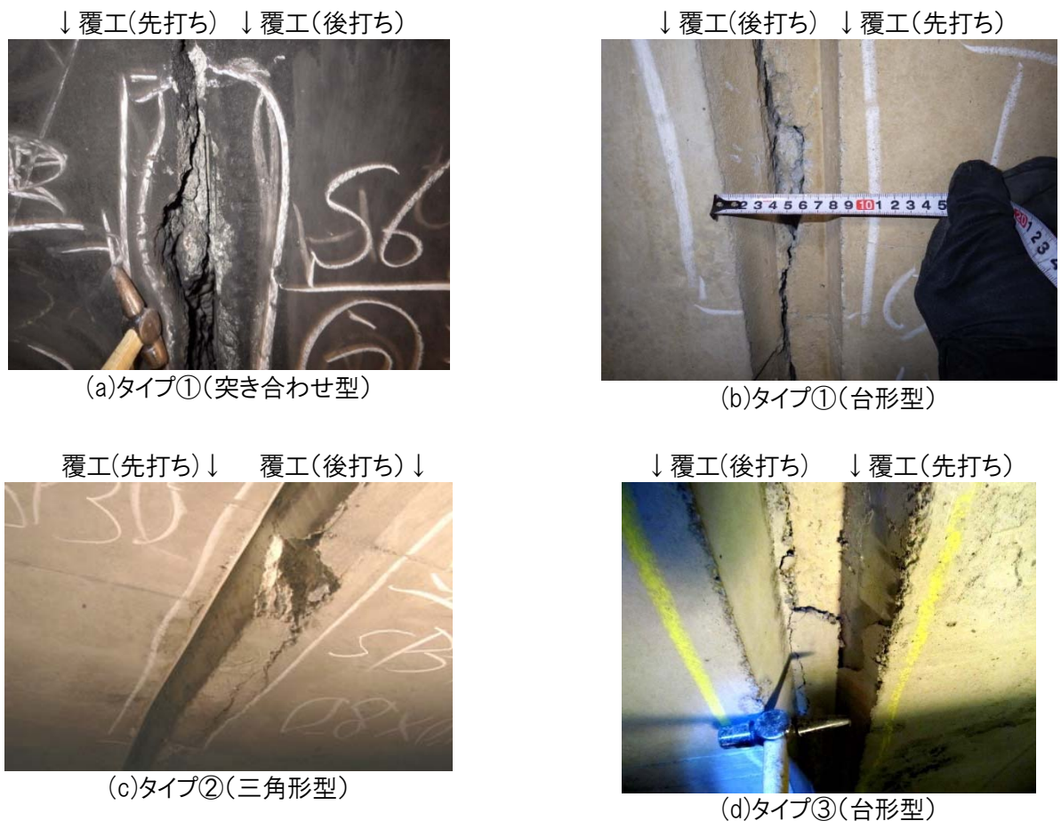
付写真-1.1.2 横断目地付近で発生する変状の例
