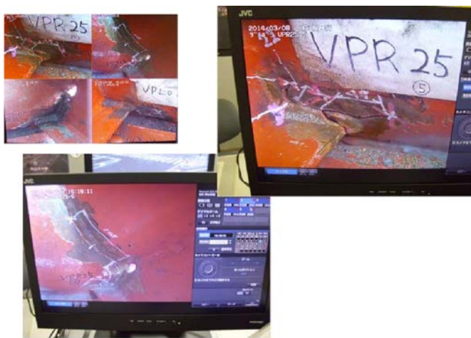
①橋台部の亀裂把握(画像)
