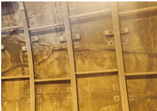
▲覆工に発生しているひび割れ
