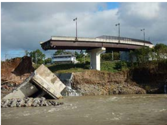
橋台の流出 橋脚基礎の洗掘
