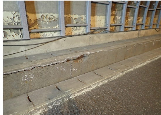
▲監査路に発生しているひび割れ
