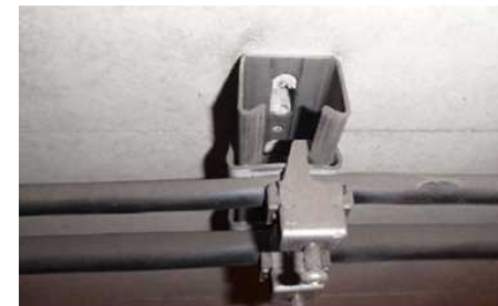
アンカーボルトの脱落の例
