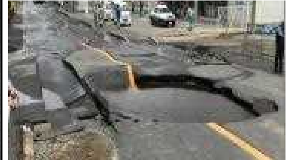
破損現場(高槻市下田部町)
