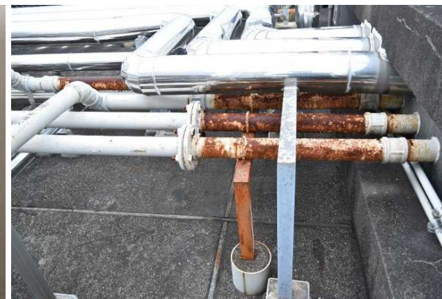
屋上 : 配管の腐食
