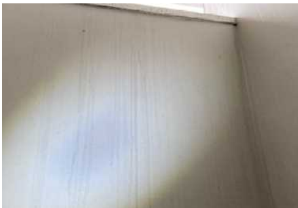
階段室 : サッシからの漏水跡
