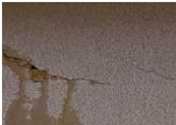
3F東 : 内壁クラックからの錆汁
