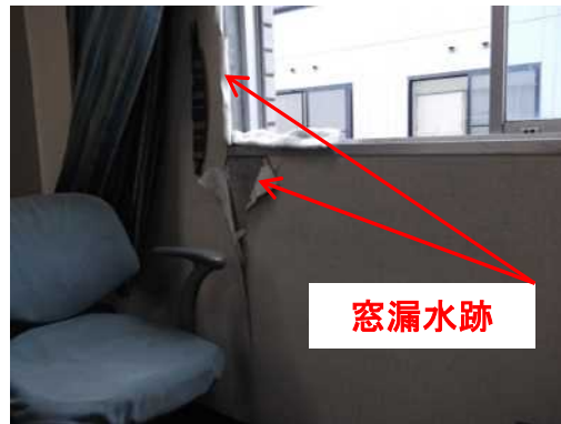
打合室：室内の壁に漏水がみられる
