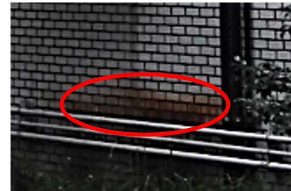
外壁：外壁にひび及び内部鉄筋からの発錆が見られる
