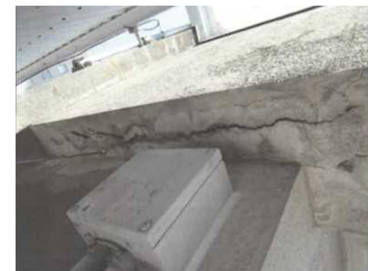
外壁：壁の見上げ部分にひび割れ(爆裂)見られる
