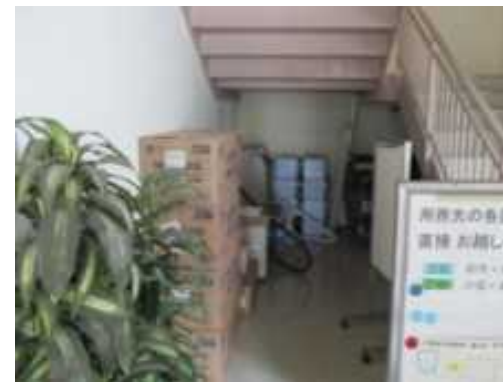
階段室：倉庫が不足しており、階段室まで備品が溢れている
