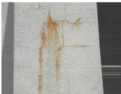
外壁：外壁にひび及び内部鉄筋からの発錆が見られる
