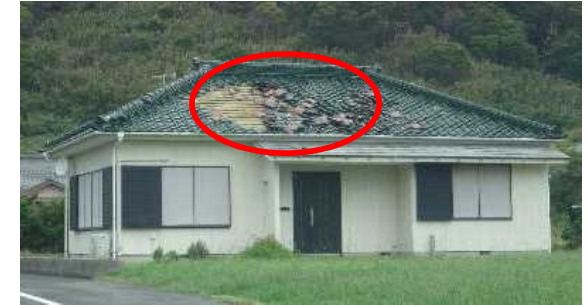
強風による屋根の被害(南房総市)
