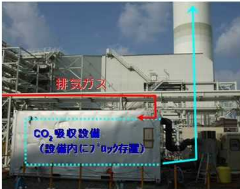
炭酸化養生設備
