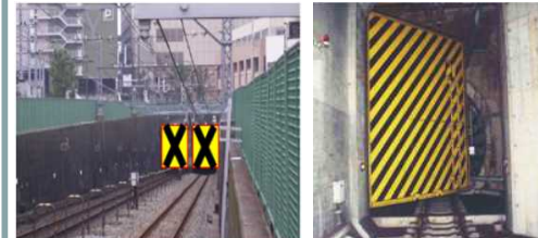
防水扉(坑口) 防水扉(トンネル内)
