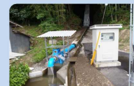
▲ 発電所設置後の現況
