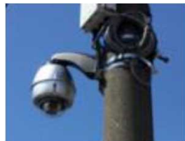
積雪状況を監視するカメラの増設
