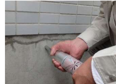
リバウンドハンマーを用いたコンクリートの圧縮強度の測定
