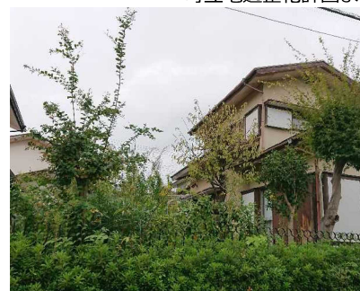
植栽が繁茂した空家。所有者に連絡し、管理行為が行われたものの、再度繁茂しつつある。
