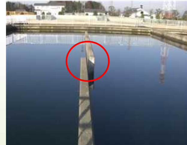
配水池導流壁の被害状況(傾倒)
