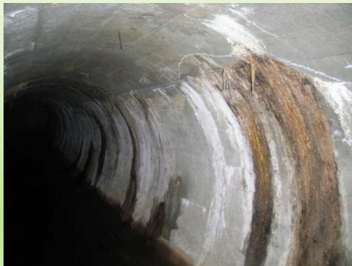
赤川ダム取水塔から続く導水路の漏水(宇都宮市)
