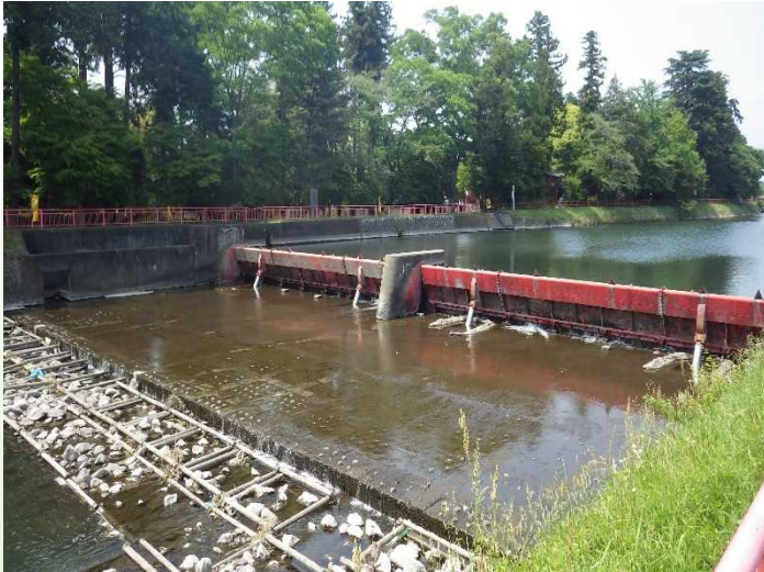
穴川用水大前堰の漏水(真岡市)
