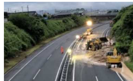
九州自動車道（横川～溝辺鹿兒島空港）の被害状況
