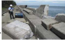
高波による護岸倒壊事例(令和元年房総半島台風) [横浜港]
