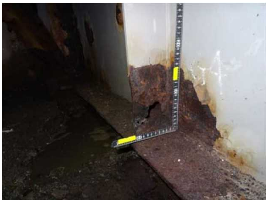
国管理 主桁腐食・欠損
