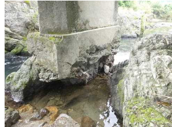
地方自治体管理 橋脚洗掘
