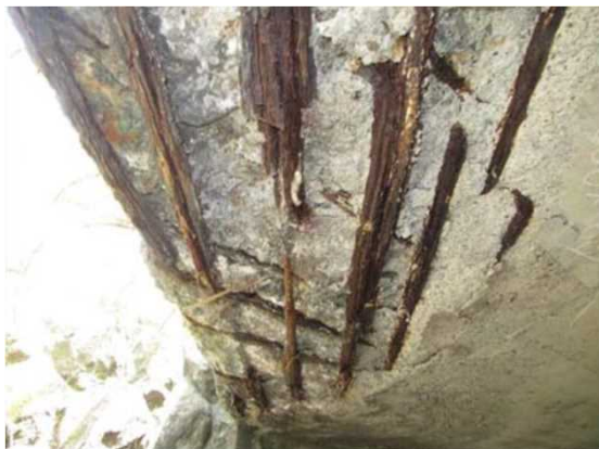
国管理 床版鉄筋露出
