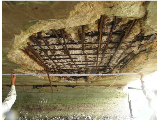
地方自治体管理 床版鉄筋露出
