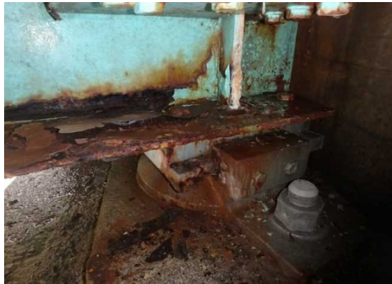
地方自治体管理 主桁腐食
