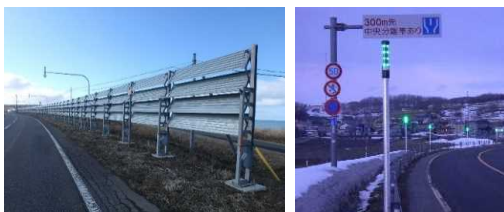
防雪柵の整備
