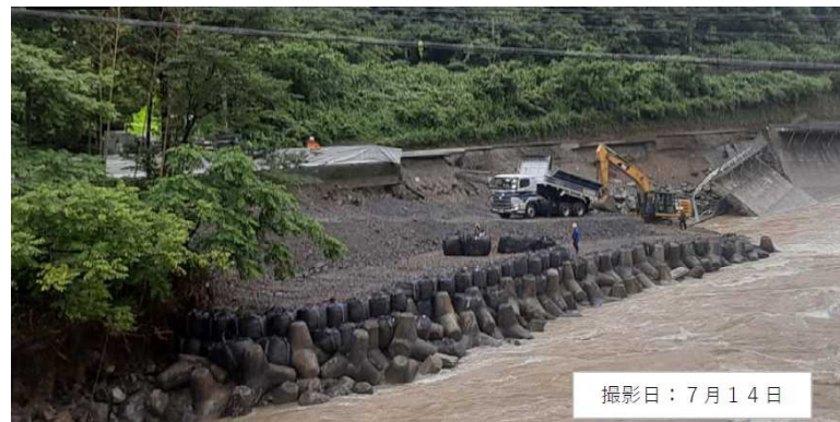
国道41号下呂市門坂地区道路流失
